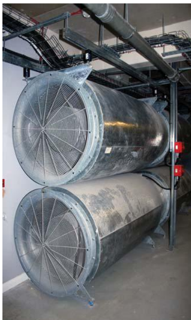
Ventiladores de extracción en The Foundation, Liverpool
