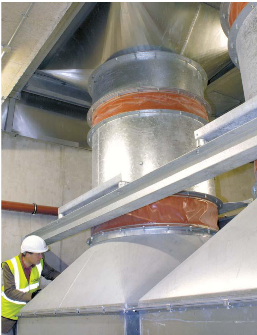
Planta de extracción en Gunwharf, Portsmouth
